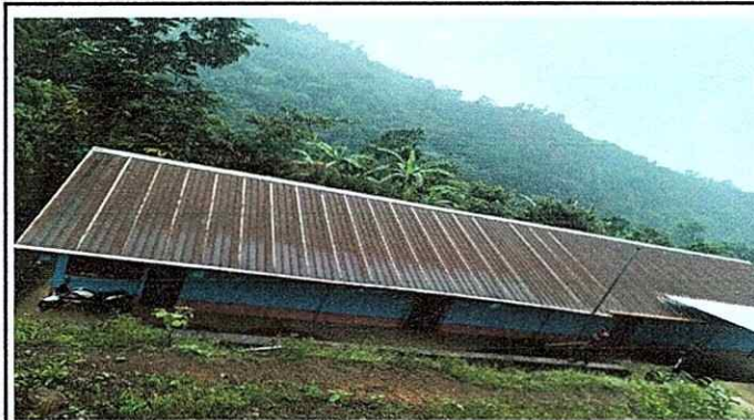
Foto 3: Cambio de cubierta de lamina, se encuentra en mal estado
